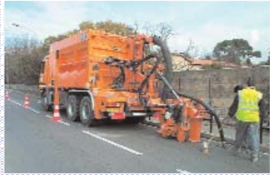
Procédé de microtranchée pour pose de réseau urbain sous trafic - Groupe Marais
